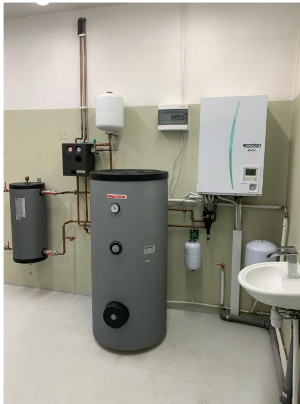
Slika 1: Učna kotlovnica (Lasten vir)
