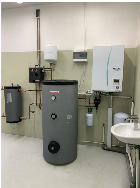
Slika 1: Učna kotlovnica (Lasten vir)
